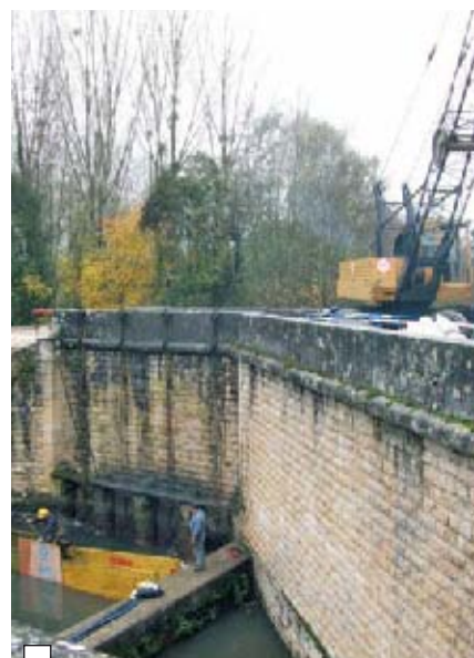
Dévasement du site et pose de 4 vannes murales motorisées, tout-inox, en remplacement des 4 pelles en fonte et bois.
